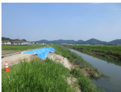
写真-1 河川堤防法面の決壊
